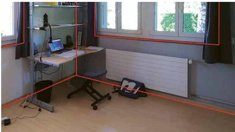
Figure 6.52 : Pour pouvoir garantir un bon fonctionnement du système, il faudrait étancher les joints sur une longueur de 25 m.
