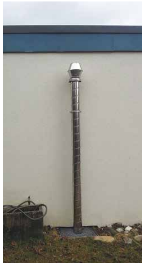
Figure 6.65 : Un système de mise en dépression du terrain a été installé dans le vide sanitaire.
